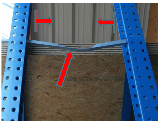
Diese beiden Stützen sind aus dem Lot
